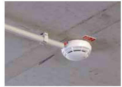
Optische Rauchmelder alarmieren bei einem Brand.
