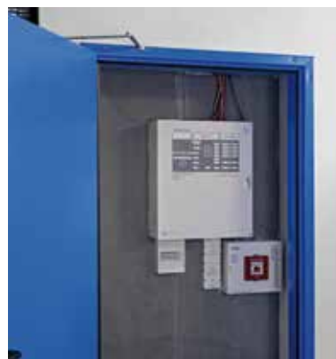
Die Installation der Brandmeldezentrale, für die ein separater E30 Brandschutzraum gefordert war, erfolgte innerhalb eines entsprechend geschützten Bereichs im EDV-Raum. Bilder: Telenot Electronic GmbH
