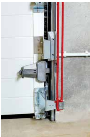
Der Versandbereich wird mit Tür- und Rolltorkontakten geschützt.
