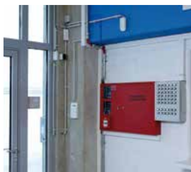
Für Sicherheit am Personaleingang wurden cryplock-Zutrittskontrollleser neben den Türen angebracht. Auch die Einbruchmeldeanlage lässt sich an diesen Lesern scharfschalten.
